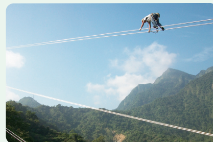
輸電線路工程
