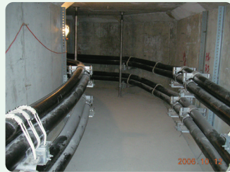
▼ 台電週美~北資輸電線路工程
